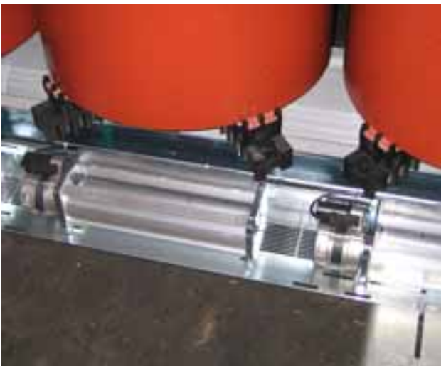
Рис. 14. Внешний вид системы принудительной вентиляции
